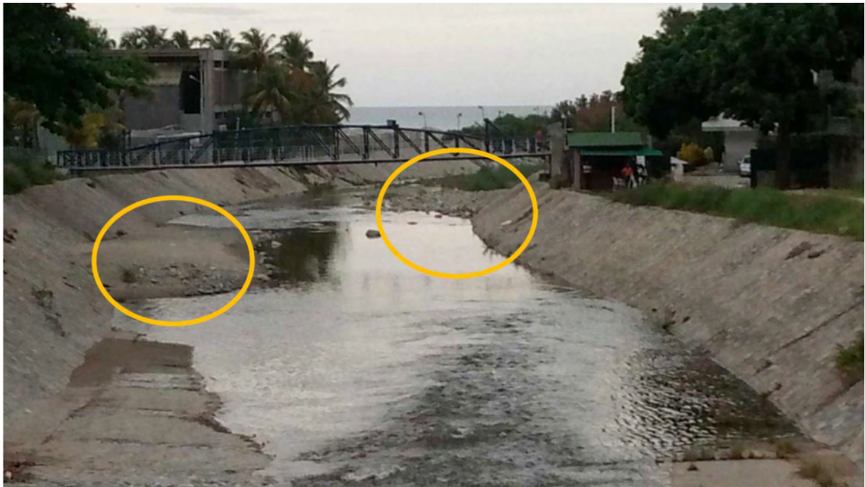
Figura 26. Tramo inferior de la canalización en concreto del río Camurí Grande, vista hacia aguas abajo desde el puente en la Av. Costanera, mostrando acumulaciones de sedimentos en el lecho que explican las perturbaciones superficiales y los desbordes que ocurrieron hacia el Club Camurí Grande (foto del 12-09-2021).
