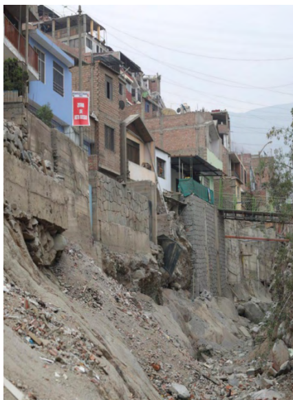
Figura 7. Viviendas declaradas en alto riesgo. F/ Google Imágenes
