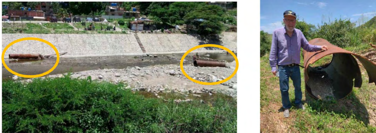
Figura 24. Restos de los tubos depositados aguas abajo en el lecho de la canalización del río Camurí Grande. El diámetro de los tubos es de 1,10 m (Foto tomada el 12/09/21).
